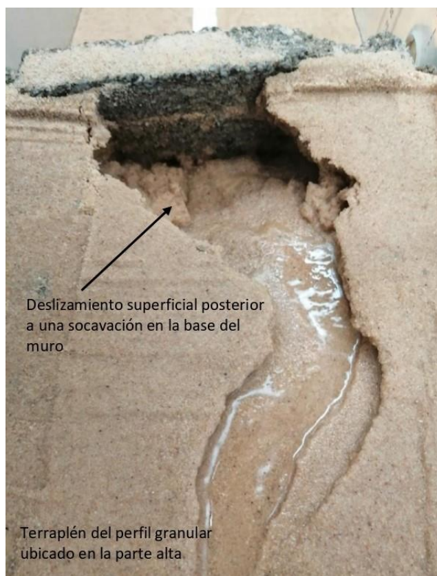
Figura 6. Presentación de la socavación del muro de contención y deslizamiento superficial en la parte alta del perfil granular, generados por el gradiente más desfavorable.
